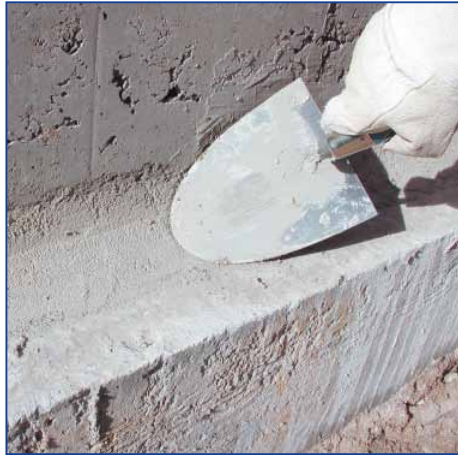
2 Hohlkehlen mit INTRASIT® FSM Winter 56Z im Radius von ca. 5 cm ausbilden. Ausbrüche im Mauerwerk sowie zurückspringende Fugen (> 5 mm) ebenfalls mit INTRASIT® FSM Winter 56Z schließen.
